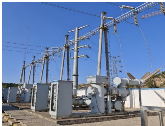
吴堡 110kV 变电站工程
