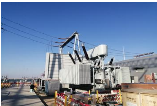
国网河南新乡 220kV 产品投运
