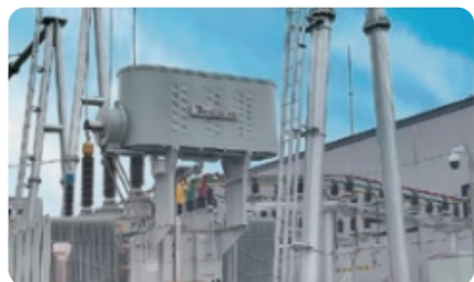
S35-500kV电力变压器
