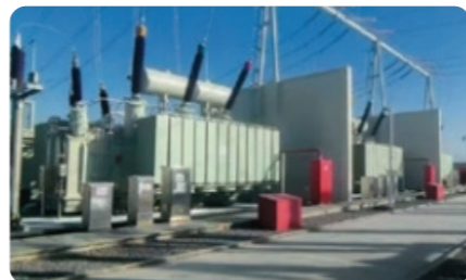
新能源变压器
