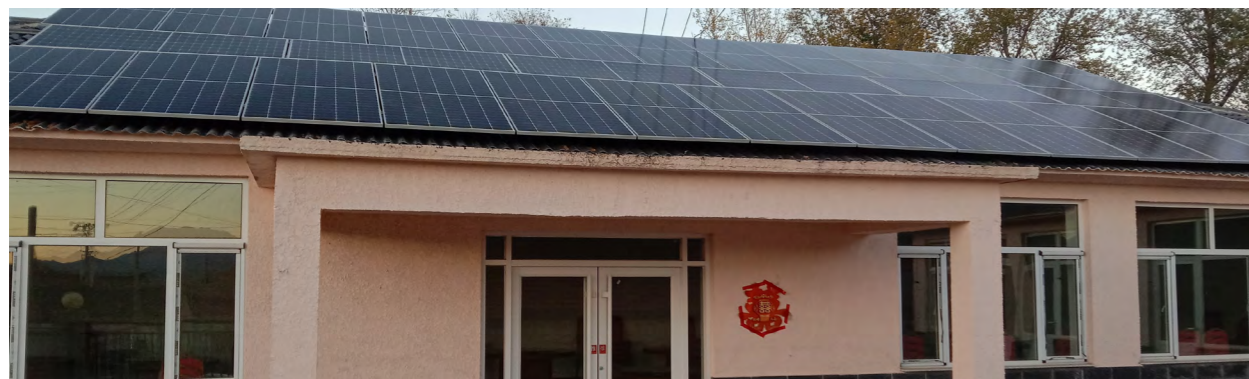
两间房村光伏电站实景
