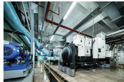
达实大厦超高效冷站
