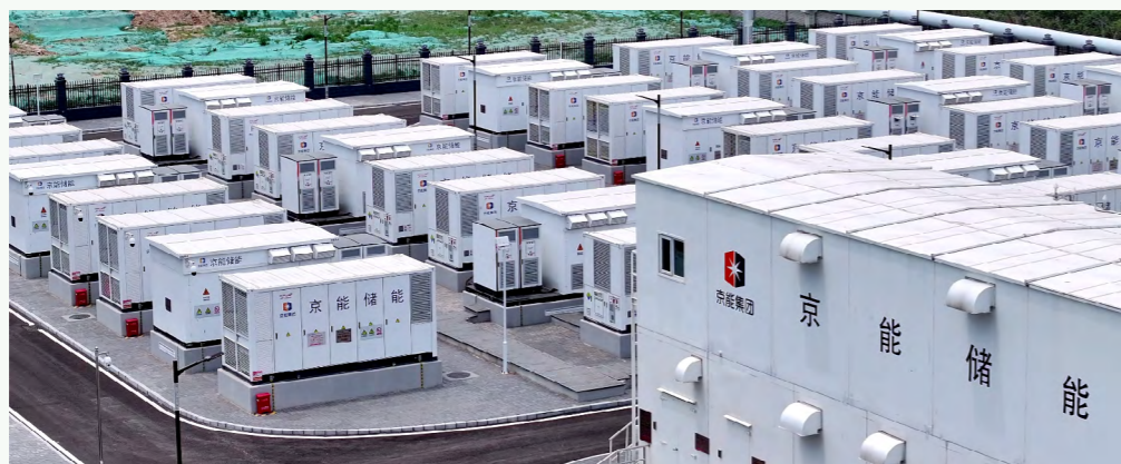
带有配电楼的储能现场
