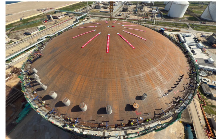
2025 年 2 月，中核五公司承建的阿尔及利亚国家石油公司 SONATRACH 新建 15 万方 LNG 项目完成储罐穹顶气压顶升
