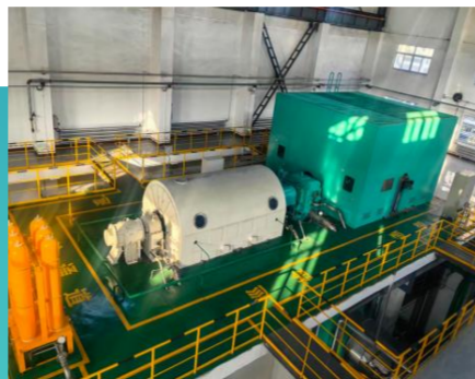
图注：华盛化工新增余热发电机组
