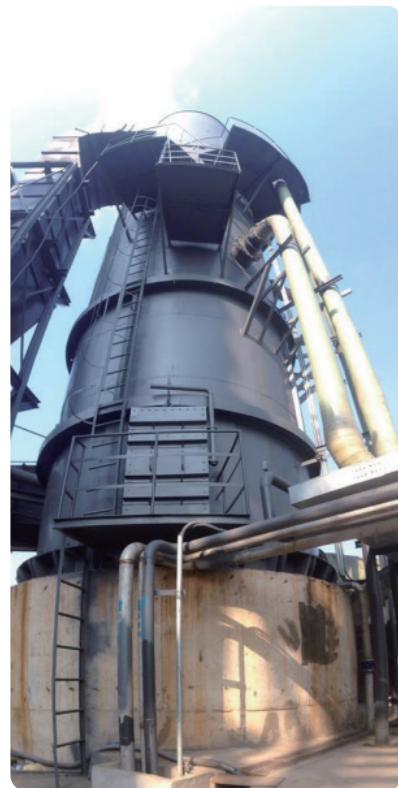
SNCR脱硝系统
