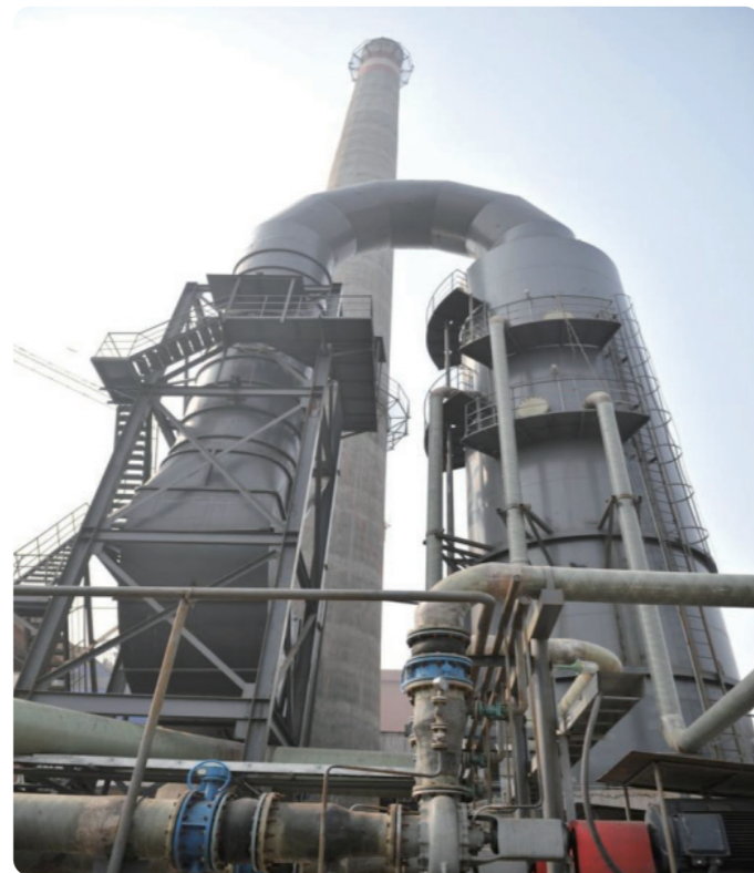
石灰-石膏炉外脱硫设施
