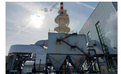
锅炉除尘净化设施
