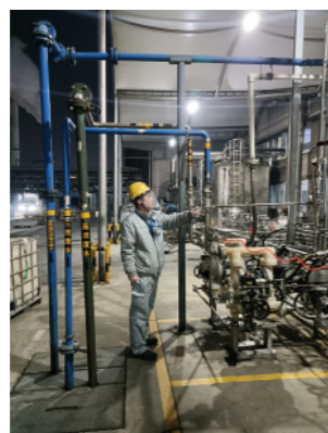
跑冒滴漏检查
