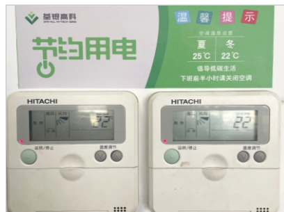
空调智能管控
