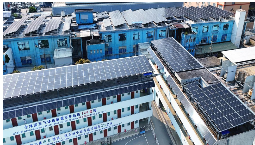
深圳明阳光伏项目
