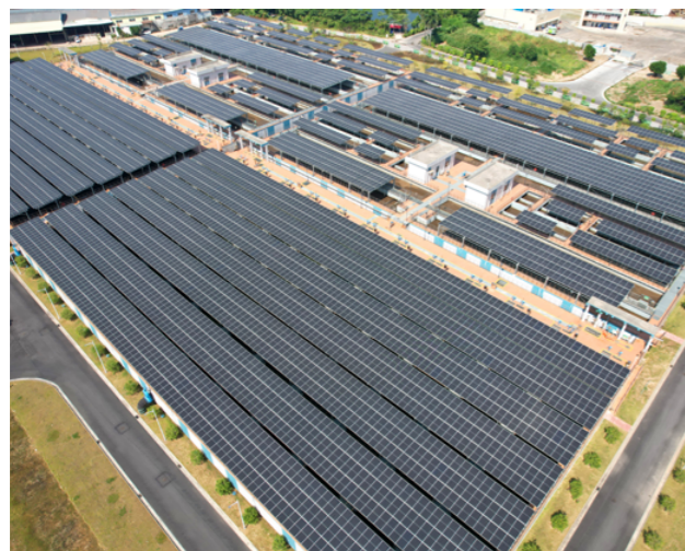
中嘉污水处理厂光伏发电项目
