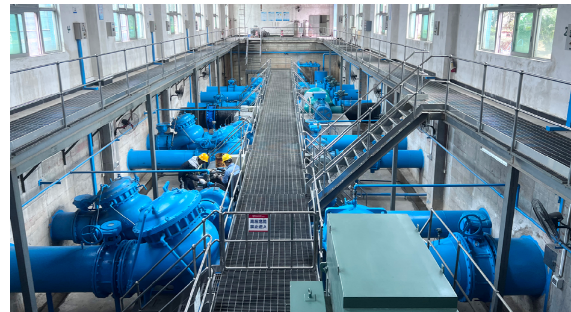
古镇水厂泵房机组
