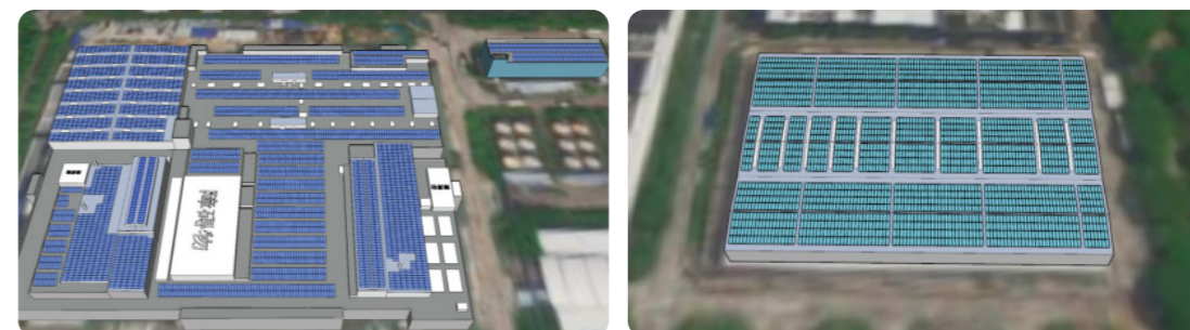
生益科技七期、八期屋顶光伏项目
