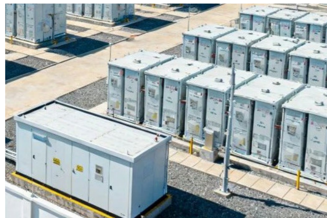
混合储能发力，科力远等联合体成员斩获 5.2GWh 独立储能电站项目
