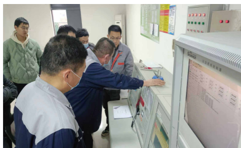
○ 公司现场隐患排查
