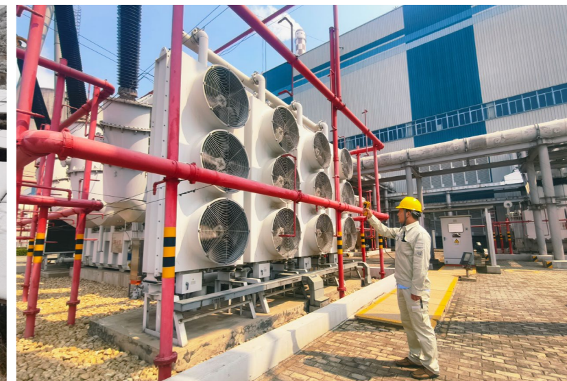
田集电厂巡检人员在迎峰度夏期间增加检查频次， 对主变、汽轮机等重点设备“把脉问诊”
