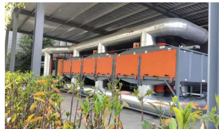
● 废气处理设施 ●
