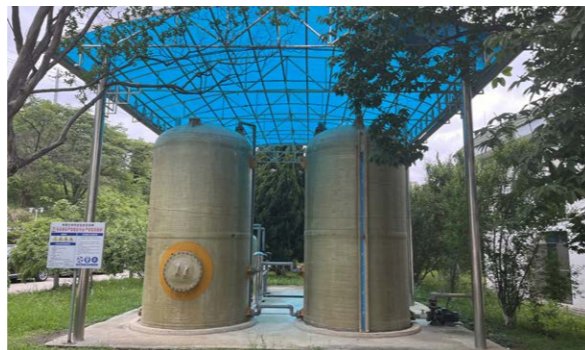
贵州创业水务有限公司中水处理装置
