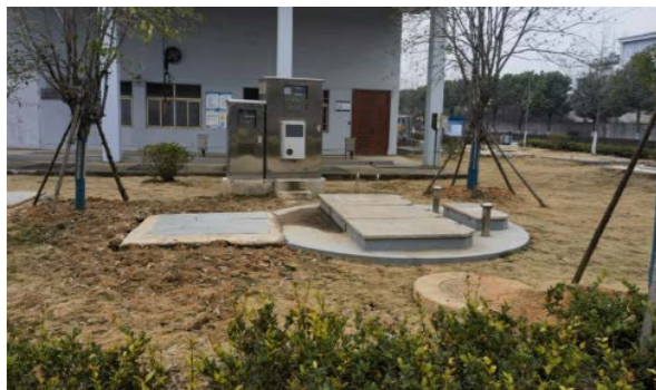
咸宁创业水务有限公司中水泵站
