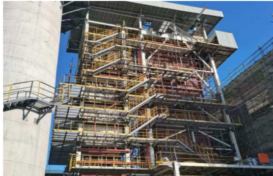
国铭铸管高炉煤气发电项目
