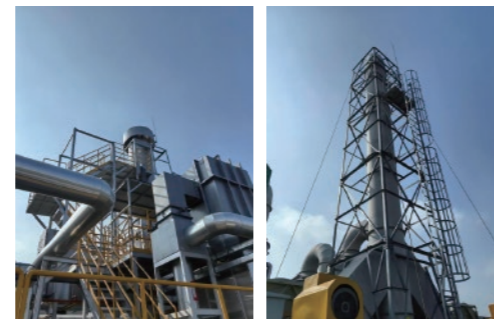
废气处理设施
