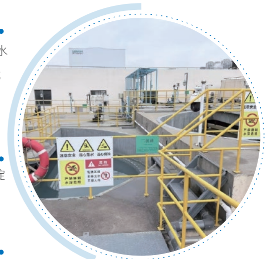
废水处理措施
