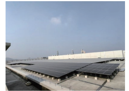
立昂东芯屋面光伏发电站
