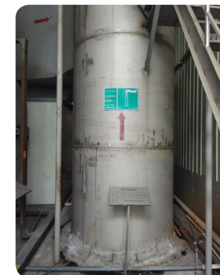
废气处理设施
