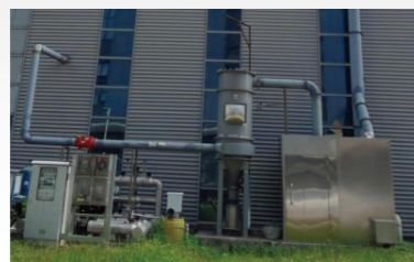
布袋除尘设施
