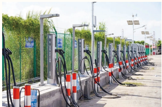
廈門海投供應鏈綠色充電站
