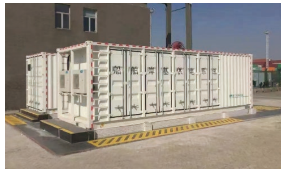
船舶岸基供電系統
