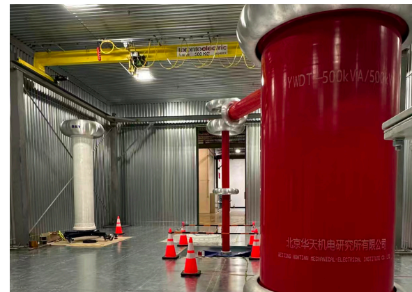
加拿大, 传奇, 500kV1A 工频和 500kV50pF 标准电容器设备现场
