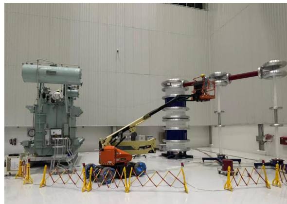
印度, Atlanta, 500kV2A 调感串谐现场
