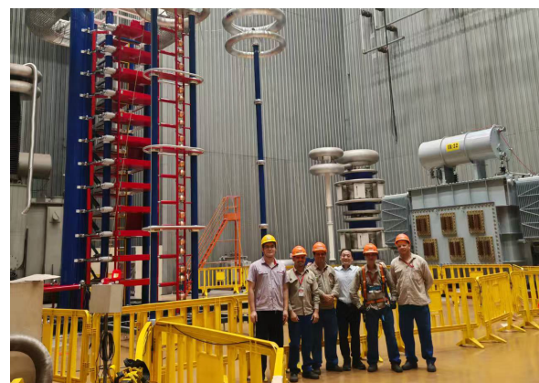
巴西, TSEA, 2400kV360kJ 冲击设备现场
