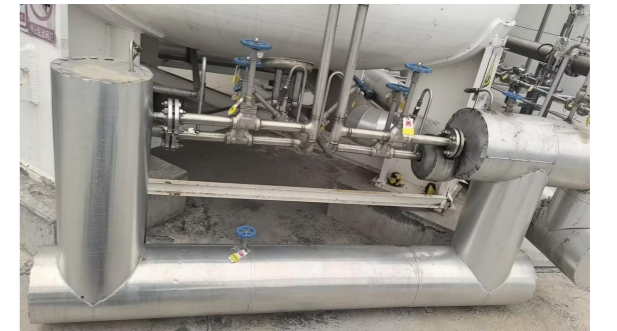
弘元徐州液氮采出收集装置
