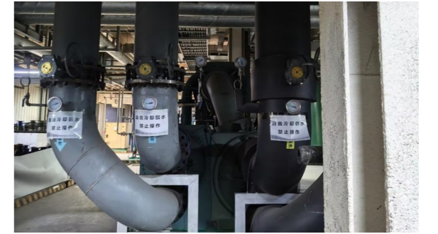
弘元新材空调冷却塔冷却水循环系统
