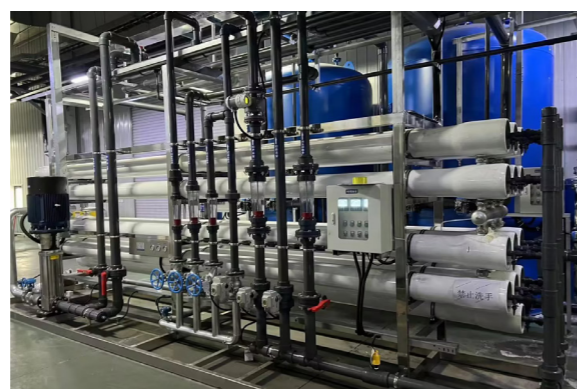
弘元新材 RO 浓水回收装置
