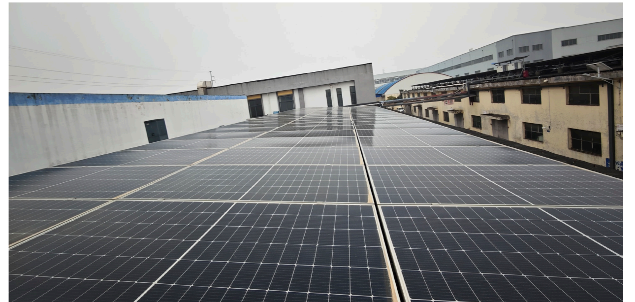
龙瑞玻璃屋顶光伏
