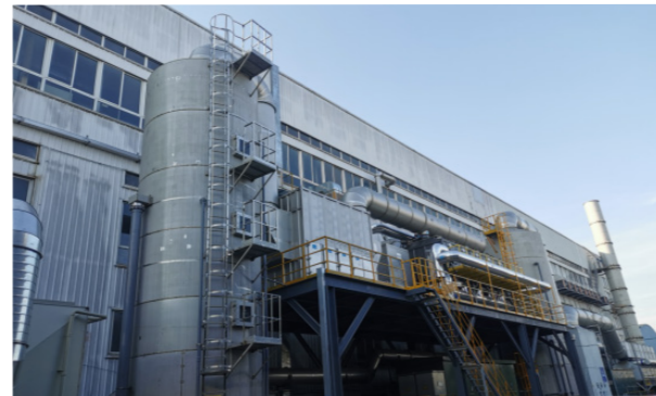
废气处理设施
