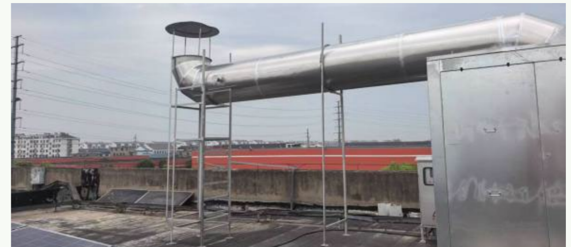
包装车间喷码废气治理项目
