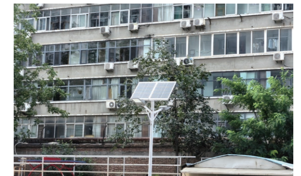
太阳能光伏路灯
