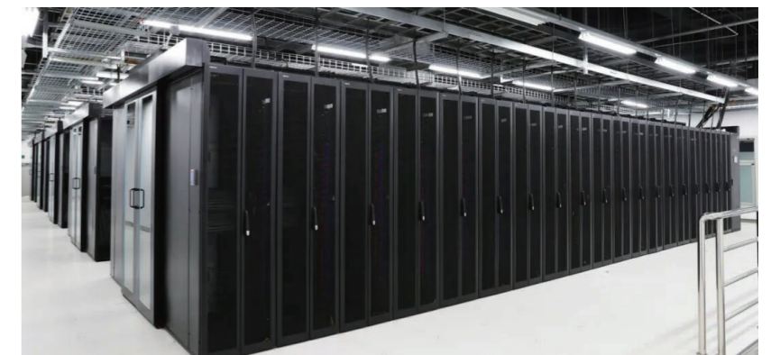
常山云数据中心机房楼
