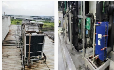
• 印尼工厂工艺循环冷却水系统
