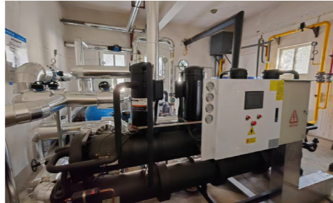
宝鸡高新区污水处理厂污水源热泵设备
