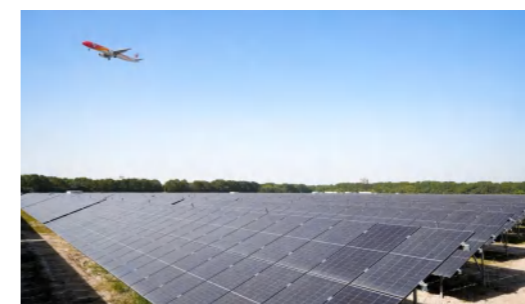
浦东机场一、三跑道北侧二期分布式光伏发电项目
