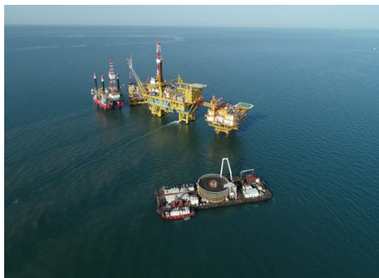
渤海秦皇岛-曹妃甸油田群岸电项目
