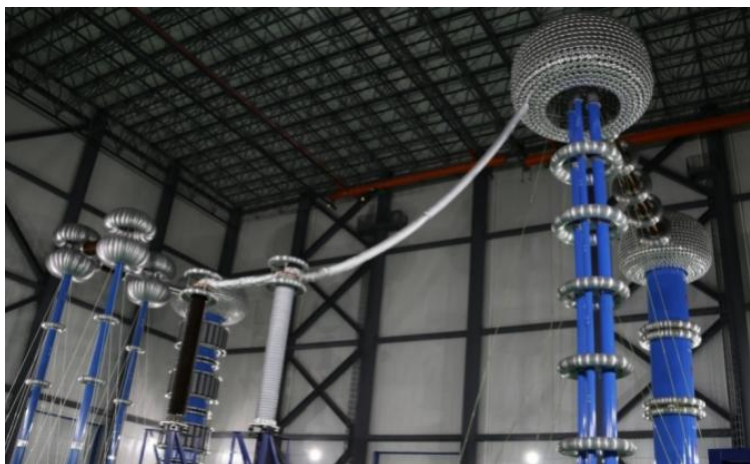
亨通超高压电力测试技术中心
