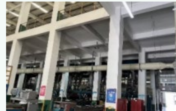
改修後：ダクトを交換し、捕集風速が基準を満たした
