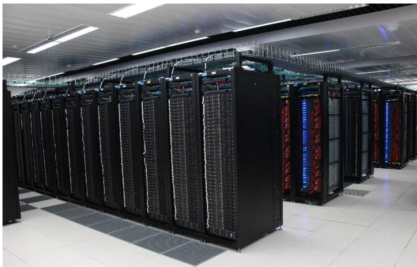
图 2-8 数据中心机房内部机柜实拍图
