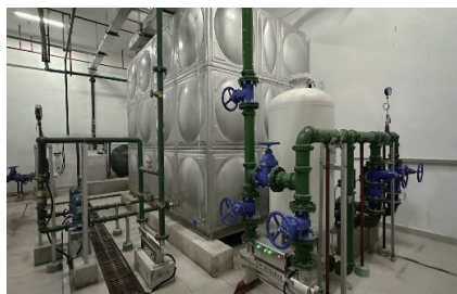
建科院未来大厦雨水收集处理装置（收集场地及屋面雨水，处理后回用）
