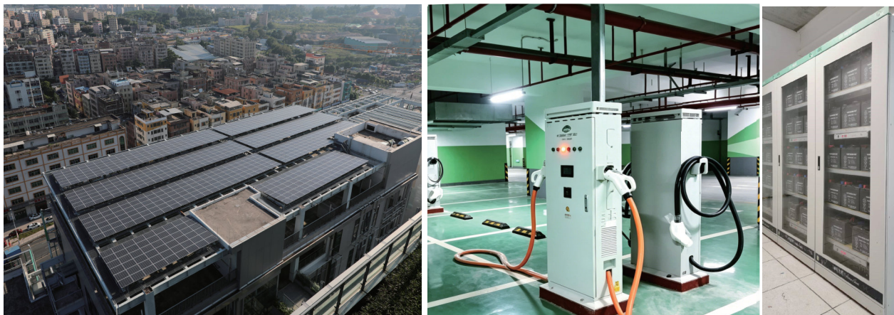
分布式光伏、充电桩与储能系统
