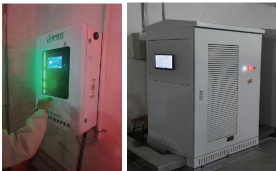
建科大楼新增充电桩系统与储能系统
