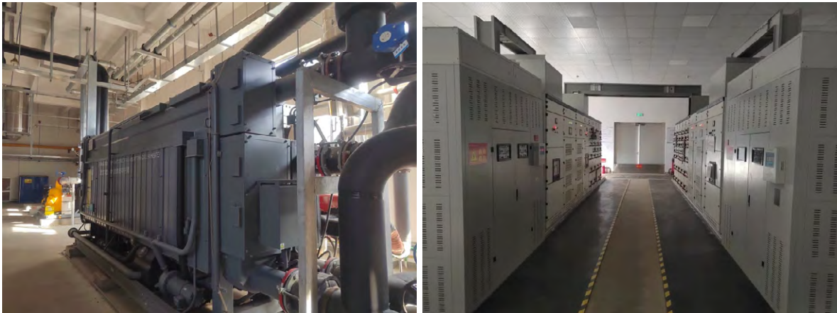
洞车公司推进园区能源管理
