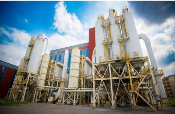
铁西三工区金谷热源厂烟气治理设施
