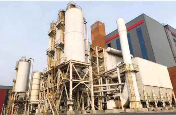
惠天环保烟气治理设施
