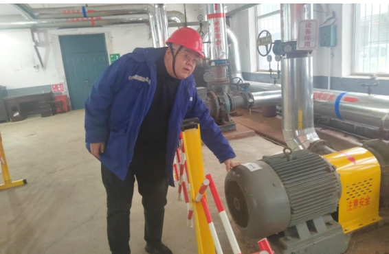
换热站内设备检查
