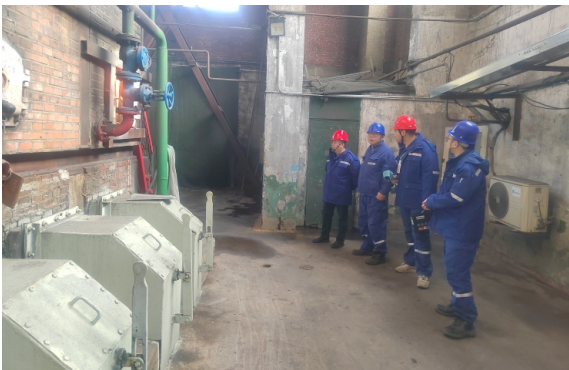
锅炉设备检查
