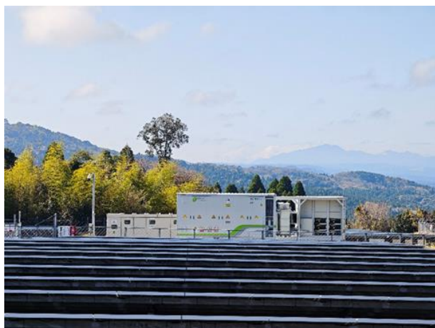
图 3：鹿儿岛 3.6MW/10MWh 储能电站
