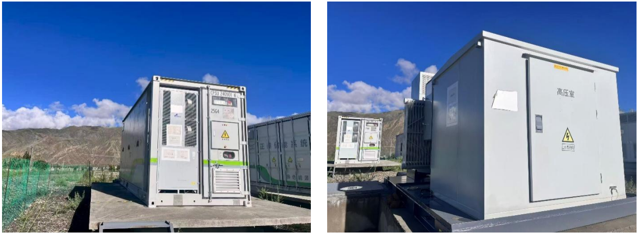
图 5：西藏自治区琼结县 0.875MW/3.7MWh 储能项目
