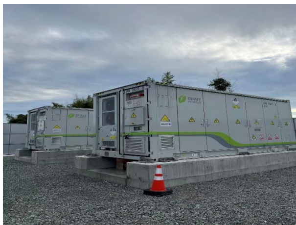
图 4：荒尾 2MW/8MWh 储能电站
