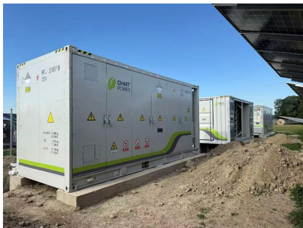
图 2：德国 10.8MW/30MWh 储能项目
