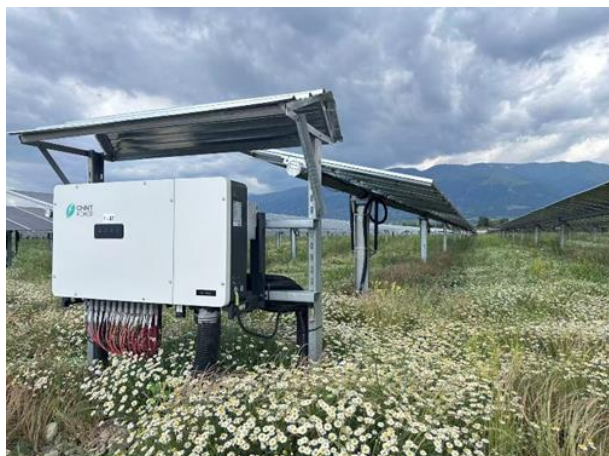
图 1：保加利亚 87MW 光伏电站项目
