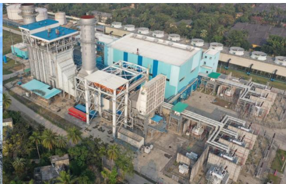
图 12：孟加拉电网项目
