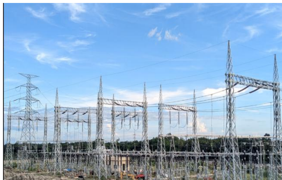
图 11：孟加拉电网项目
