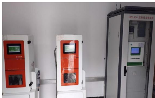
污水总排口在线监控设施
