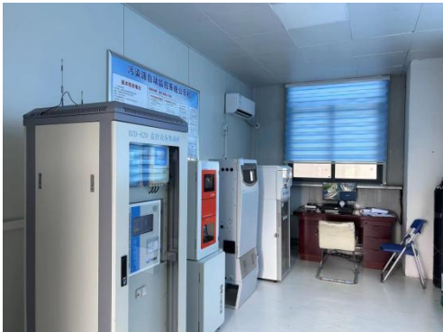
南区废水在线监控设施
