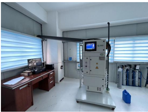
南区废气在线监控设施
