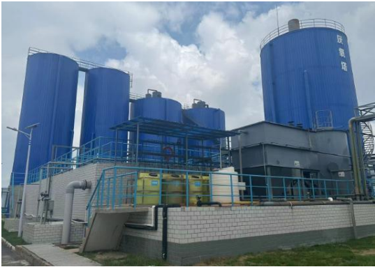
东区新建污水处理系统
