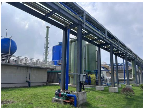
南区污水处理站
