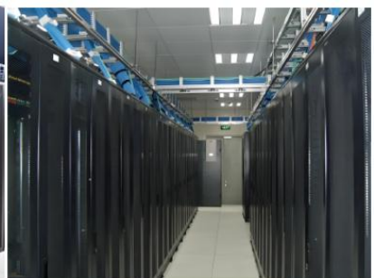
中国联通河南锚点机房油机集中改造 （集采框架）配电柜（ATS 柜）
