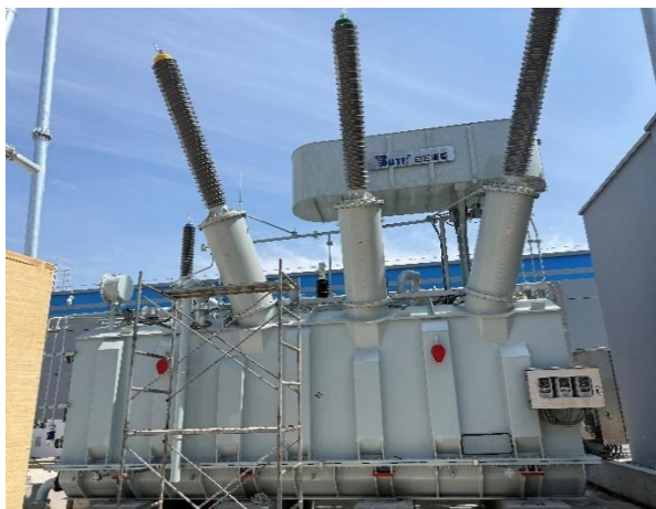
高唐县共享储能电站 200MW/400MWh
