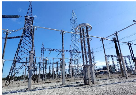
巴西伊泰普直流改造项目
