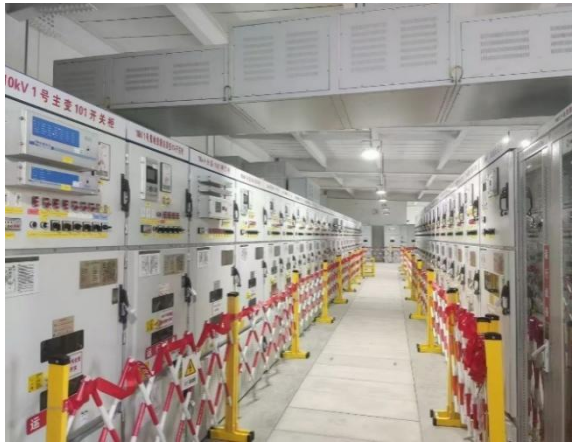
青岛黄岛世纪 110kV 变电站工程
