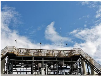
活性炭和碱液废气吸收系统
