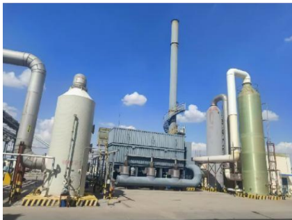
RTO 废弃焚烧系统 (蓄热式热力焚烧炉)
