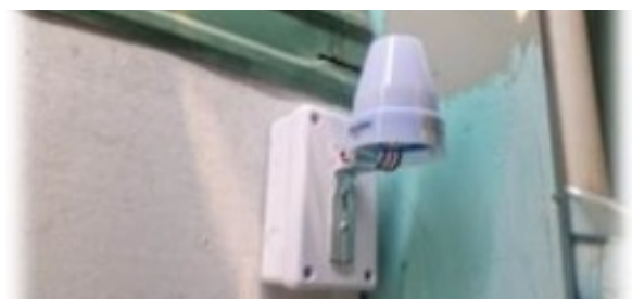
■ 印尼工廠已安裝光電感測器，取代手動照明控制並減少能源浪費。
