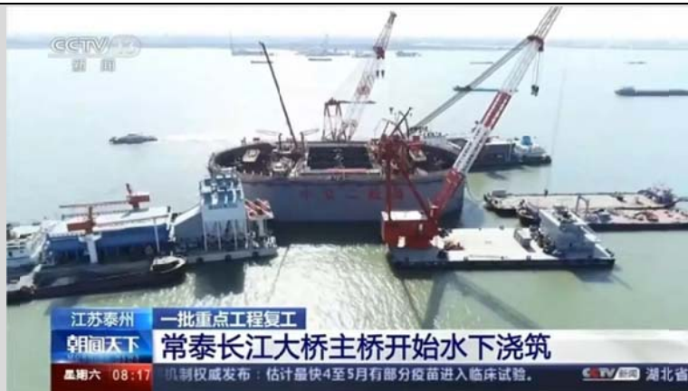
2月18日，中交二航局参建的世界最大跨度公铁两用钢桁梁斜拉桥——常泰长江大桥主桥钢沉井夹壁混凝土开始首次浇筑
