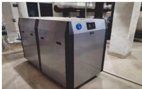
▲ 新型低氮节能锅炉
