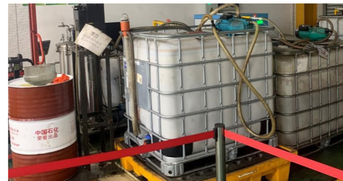
废水回收处理站
