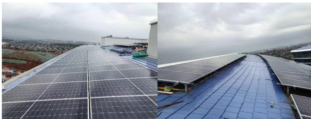
图：金地海口项目应用屋面光伏发电
