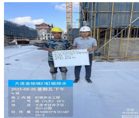
图：大连金地城项目应用地下室顶板虹吸排水系统
