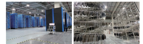
▲ AGV 机器人存储
