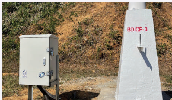
老挝南湃水电站大坝北斗位移监测点
