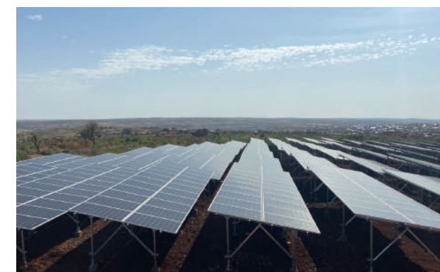
埃塞光伏微网项目
